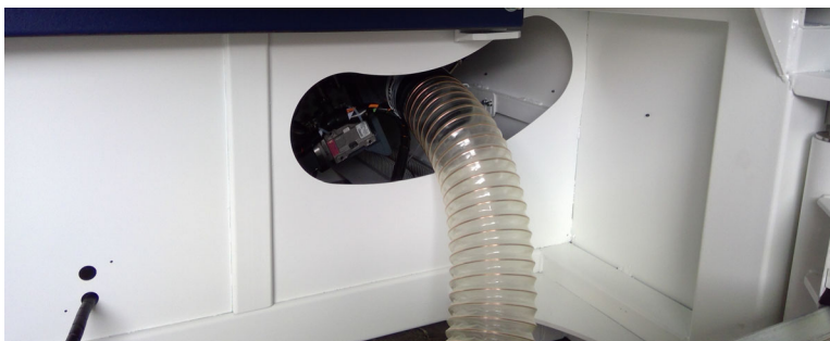
Abb.5-17: Anschluss Absaugschlauch an der Formatkreissäge
